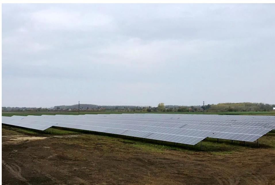
Foto – Photon Energy: Fotovoltaická elektrárna o kapacitě 1,4 MWp v maďarském Kunszentmártonu.
