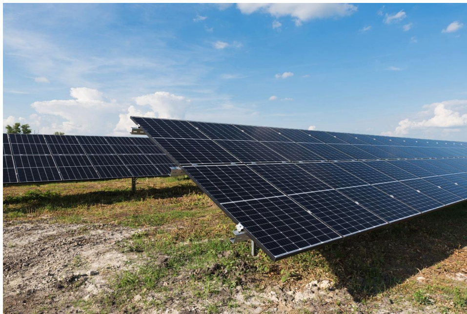
Foto – Photon Energy: Fotovoltaická elektrárna Fertőd II o kapacitě 3,5 MWp v maďarském Fertődě.
